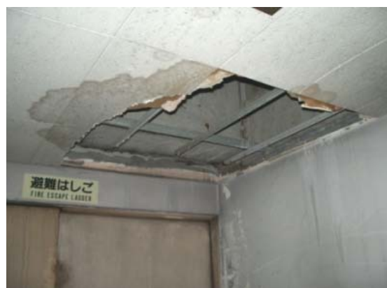
屋内への漏水
