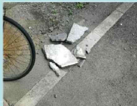
外壁モルタルの落下
