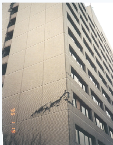
柱が破断する等構造体が損傷し、機能の復旧に時間を要した
