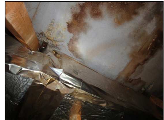
3F天井内：漏水により天井内ダクト保温材劣化、断熱材に不良発生箇所有り
