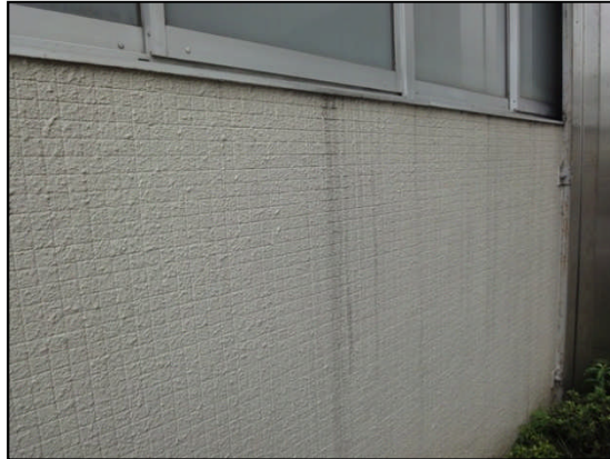
外壁：外壁改修により、新営当初のモザイクタイル上に複層塗材
