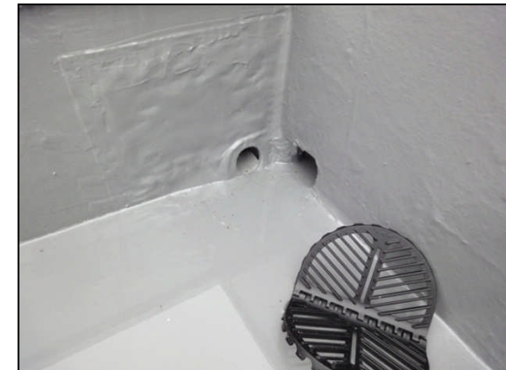
屋上ドレン廻り：漏水箇所に応急補修跡有り
