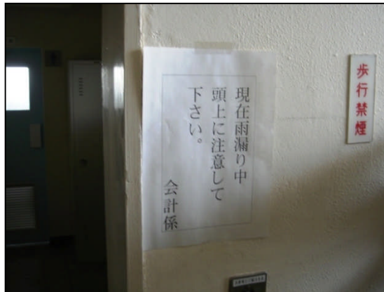
内部：一般通路部に漏水警告表示
