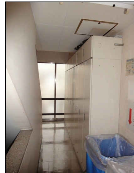
階段室：本来避難経路の階段室に壁面収納設置、移設場所無し
