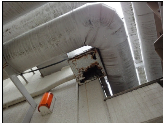
外壁廻り：配管・配線類BOX、錆び穴等、劣化部有り
