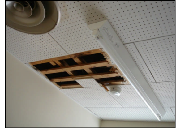
3F天井：漏水により天井材脱落、木下地表示状態
