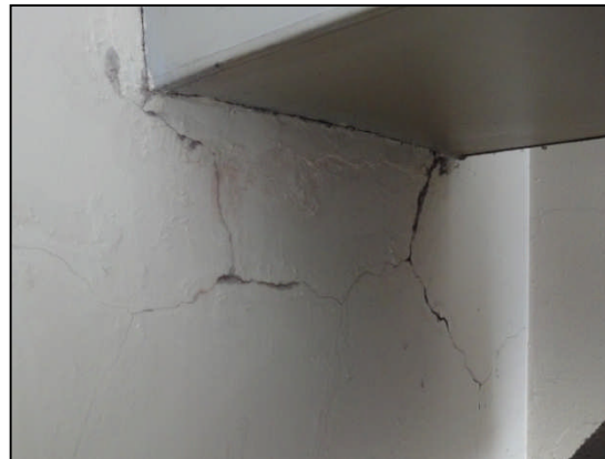
内壁：ダクト貫通部、周囲クラック・漏水箇所有り
