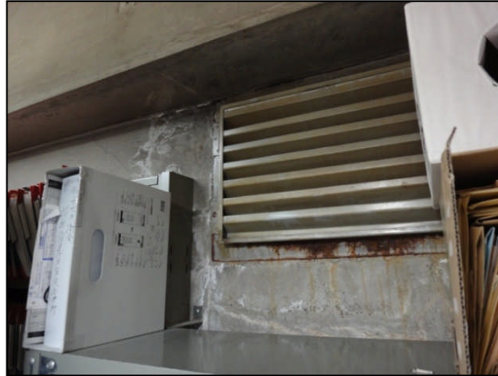
内壁：書庫内開口周囲、漏水有り、書類設置不可
