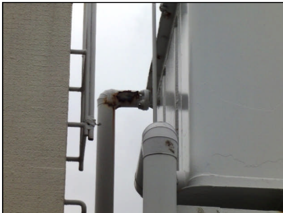
屋上高置水槽廻り：配管に錆び有り
