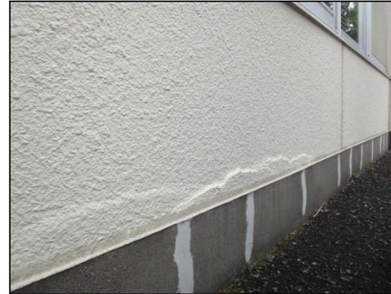
外壁：腰壁部、基礎CON部取り合い部、モルタル浮き、クラック補修跡有り
