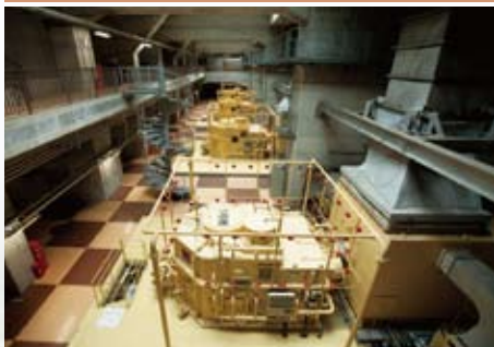
庄和排水機場ポンプ室
