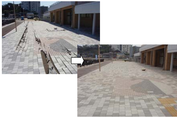
新潟県中越沖地震(公園施設)
