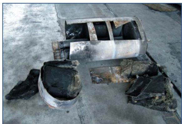
写真 24 消音器分解 (吸音材には煤、オイルが付着)
