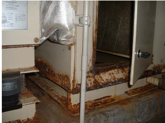
〈空気調和機の錆の発生〉
