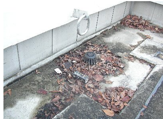
＜ルーフドレンの詰まり＞
