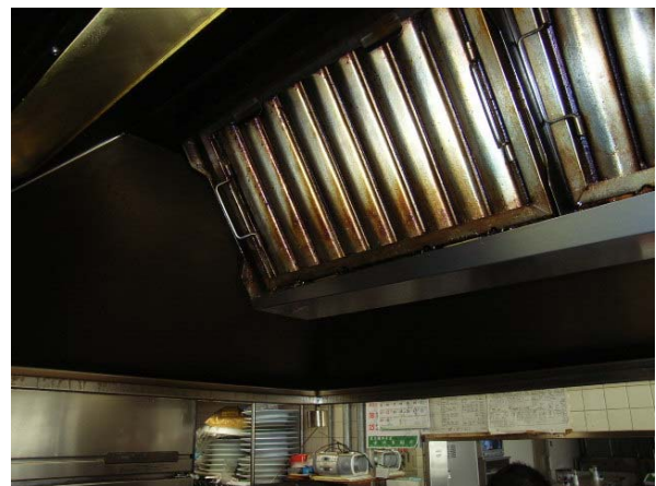
〈厨房フードに油の付着〉
