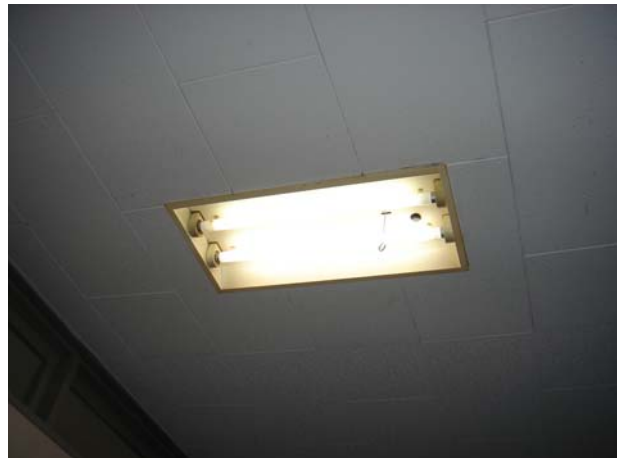
〈非常照明の点灯不良〉
