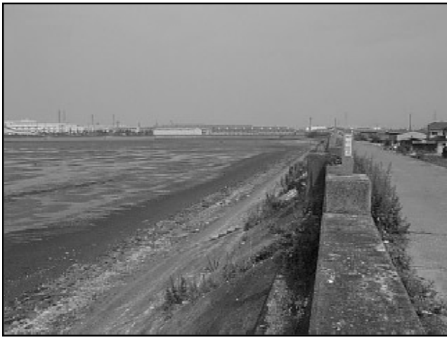
老朽化した海岸堤防
