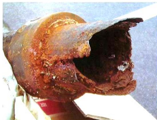
腐食した排水管
