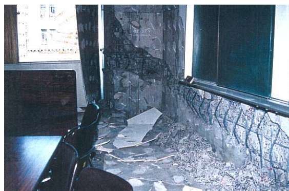
内部の被災状況
