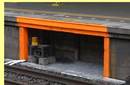
ホーム下の待避スペース
