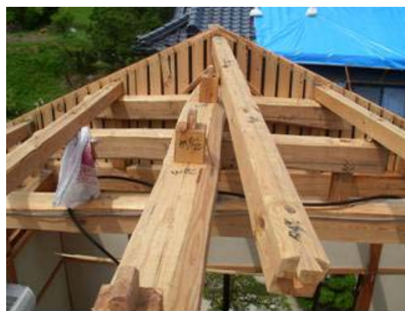
写真 2 新聞販売店の小屋組の被害状況
