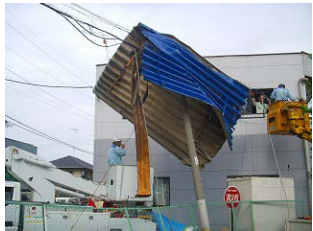
写真8 鋼板製屋根の飛散
