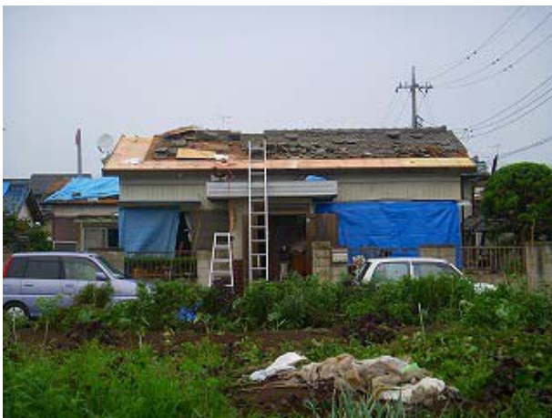
写真7 屋根瓦のずれ
