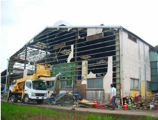
写真5 工場壁面の被害状況
