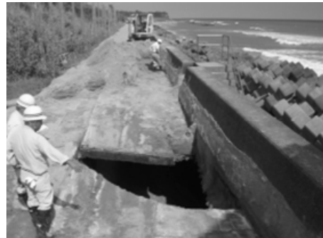
侵食による堤防天端の陥没
