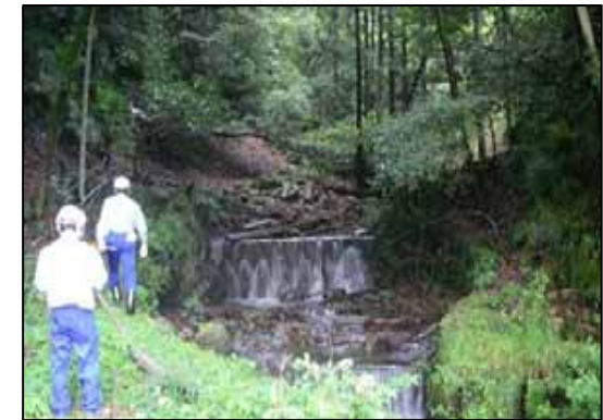
被災状況調査
