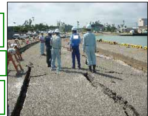
被災状況調査
