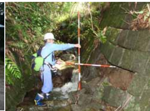
危険渓流護岸損壊状況(旧中伊豆町)
