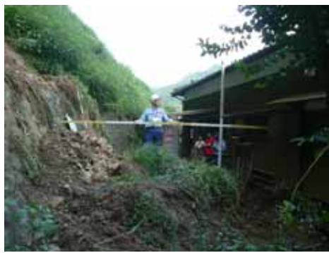
民家裏の崩落状況(旧修善寺町内)
