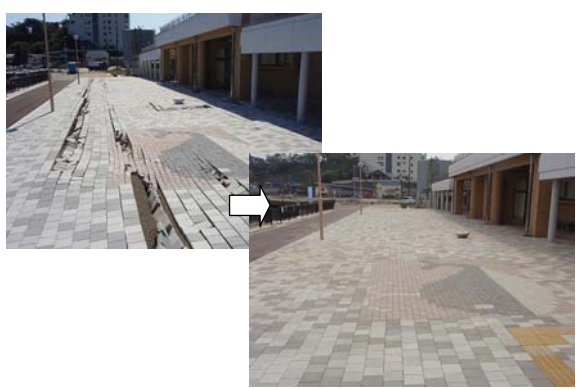
新潟県中越沖地震(公園施設)
