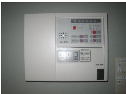
⑨連動制御盤
