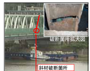
図6 本荘大橋斜材破断
