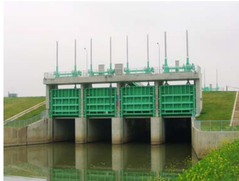
自重により確実に閉操作ができる設備
