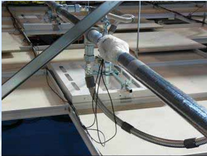
フレキ単体方式の配管接続部
