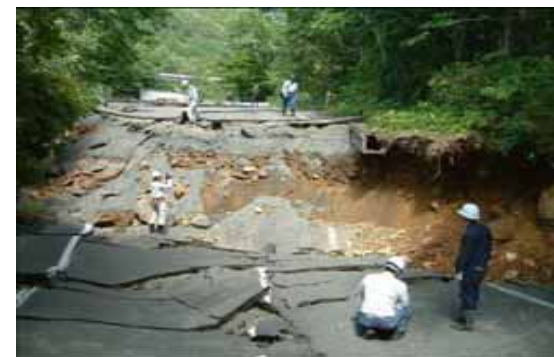
図.被災状況調査の状況
