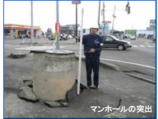
<新潟県中越地震による下水道施設の被害状況>
