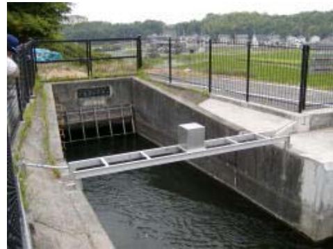
新規に追加した水位計(昭和開水路)
