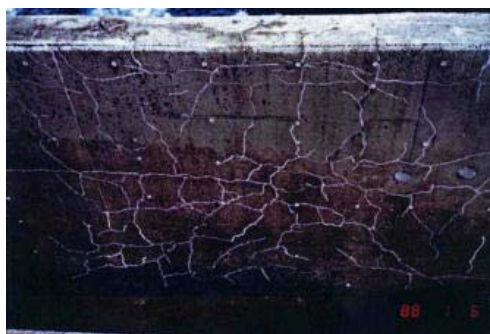
ひび割れ状況
