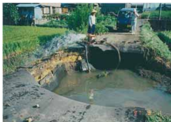
道路陥没に伴う土砂流出状況
