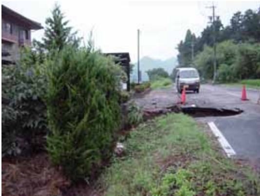
水路からの出水による民家敷地への土砂流入状況
