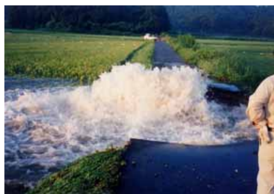
管からの漏水に伴う 農地への湛水及び農作物被害状況
