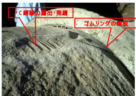
継ぎ手部からの漏水により カバーコートモルタルが削られP C鋼線が露出
