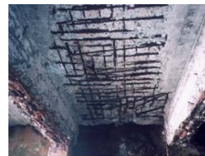
栈橋の裏面の鉄筋コンクリートが塩害により腐食
