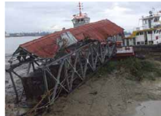
栈橋の被災状況
