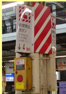
非常停止押しボタン
