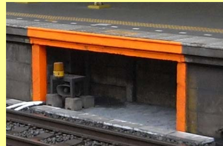
ホーム下の待避スペース
