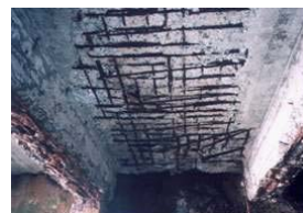
栈橋の裏面の鉄筋コンクリートが塩害により腐食
