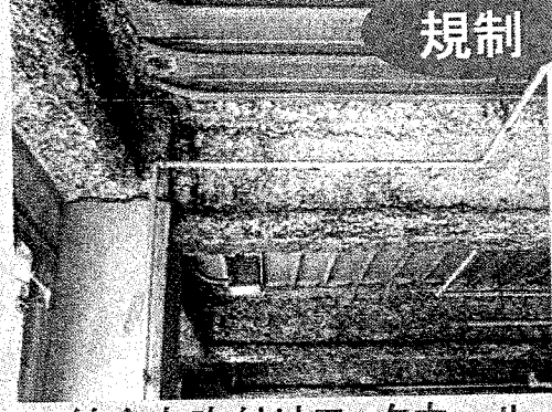
石綿含有吹付けロックウール (石綿の含有率が0.1%を超えるもの)
