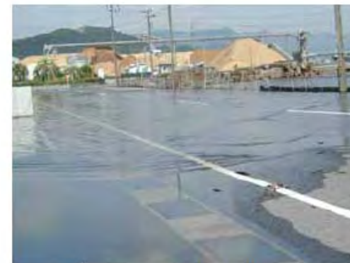
2002年9月9日 岩国 (道路の冠水)
