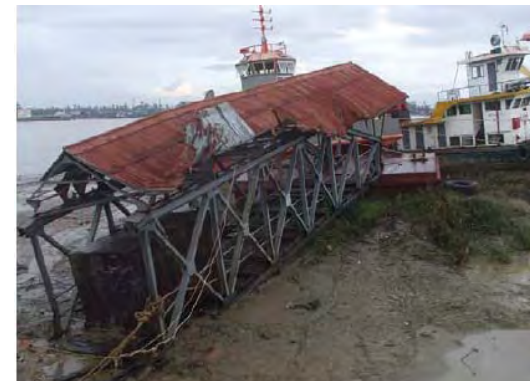
栈橋の被災状況
