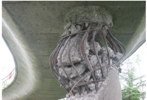
橋脚の被害（綿竹市）
