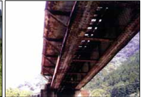
(橋桁の塗装劣化)
