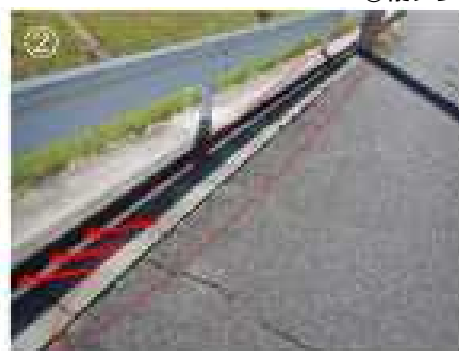
②のり肩の亀裂・谷側に傾倒
