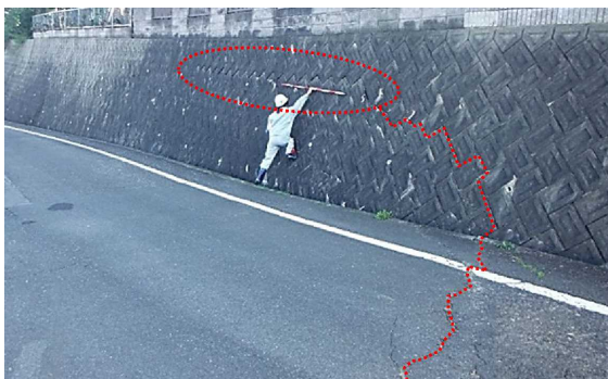
①擁壁から路面に至る連続したクラック (その1)
