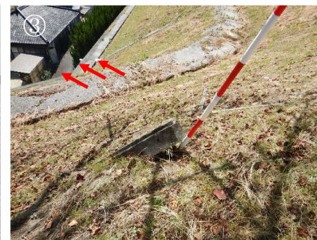
③のり面中段のハラミ・小段の亀裂
