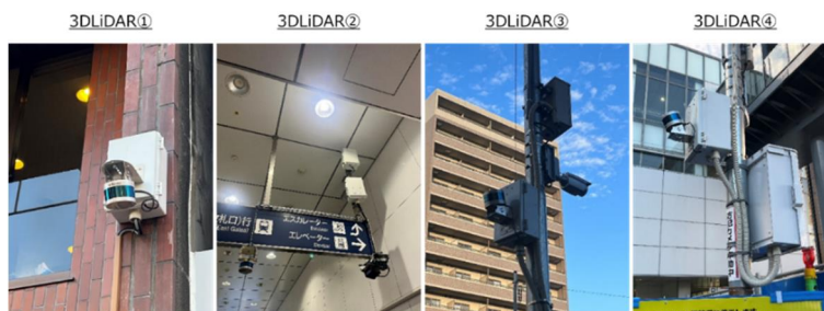
図 4-4 3D-LIDAR 設置場所
