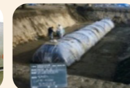
耐震性貯水槽 災害によって水道等のライフラインが断絶した場合の当面の飲料水や消防用水の確保をする施設
