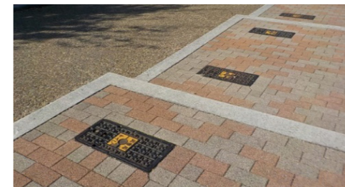
防災施設(神戸震災復興記念公園)【神戸市】 防災公園街区事業により整備を行い、公園内には防災施設として災害用仮設トイレ、ソーラー・風力照明灯、地下貯水槽、非常用自家発電装置等が整備された。
