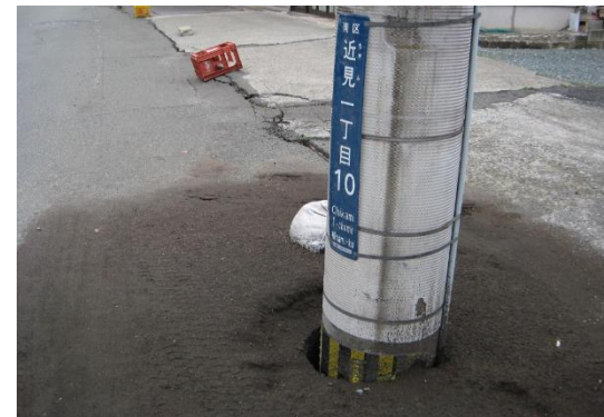
図-4 電柱の沈下（熊本市）
