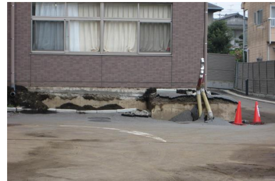
図-2 基礎杭の抜け上がりによる段差の発生（熊本市）
