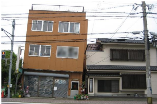
図-3 建物の傾斜・沈下（熊本市）
