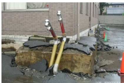
写真-1.8 埋設管の破損
