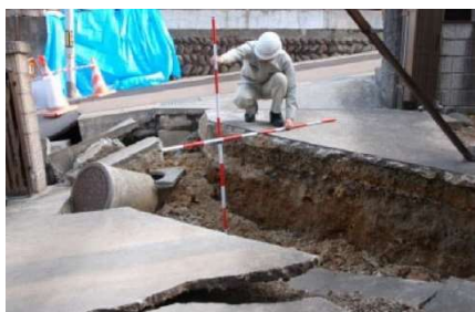
写真-1.3 宅地地盤の沈下による段差
