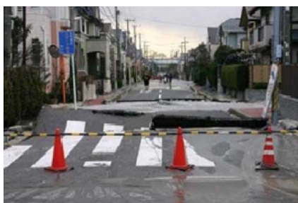
写真-1.6 道路面の変形
