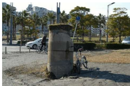
写真-1.7 マンホールの浮き上がり
