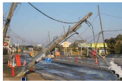
写真-1.10 電柱の傾斜
