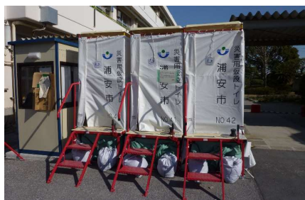
写真-1.9 仮設トイレの設置
