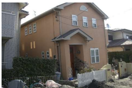
写真-1.4 戸建て住宅の沈下・傾斜
