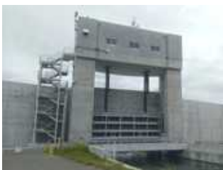
自動化・遠隔化した水門
