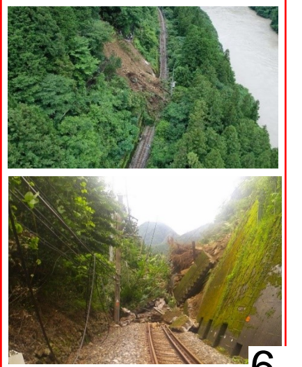
なかいさむらい こわだ JR東海 飯田線 中井侍駅～小和田駅 土留壁崩落
