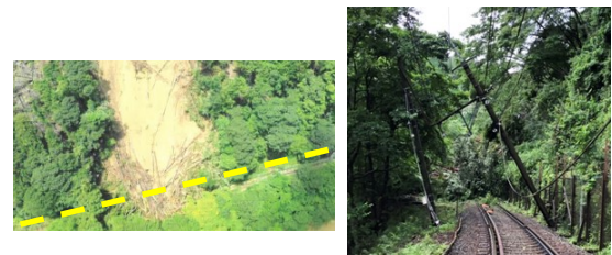
えいざん くらま にのせ きぶねぐち 叡山電鉄 鞍馬線 二ノ瀬駅～貴船口駅 土砂流入
