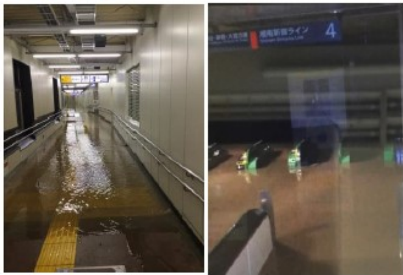
台風19号によるJR東日本管内の設備等の主な被害状況について (2019年10月13日 東日本旅客鉄道株式会社)
