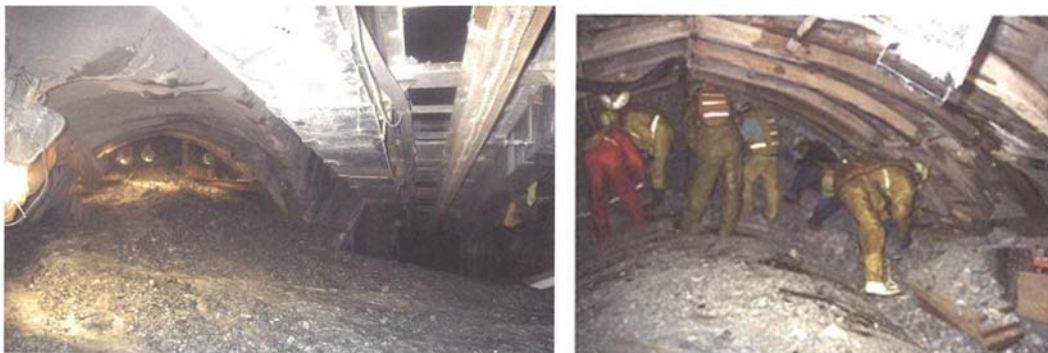
写真 7-4 飛騨トンネル TBM 土砂崩落復旧状況
