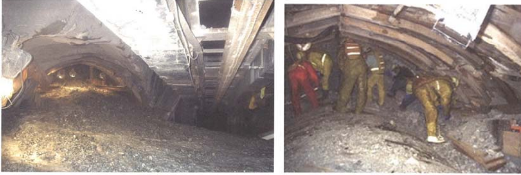
写真 7-3 飛驒トンネル TBM 土砂崩落復旧状況
