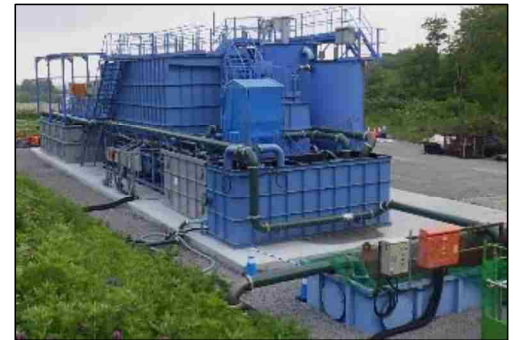
写真 濁水処理設備の例
