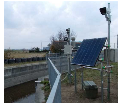
河川監視カメラによる河川状況モニタリング
