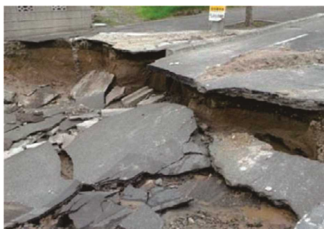
図表 地盤沈下により道路が陥没(札幌市清田区平岡地区)
