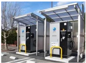
充電施設 蓄電池
