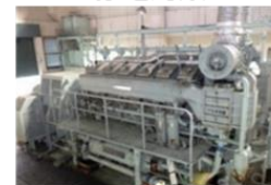
例：自家発電機の整備
