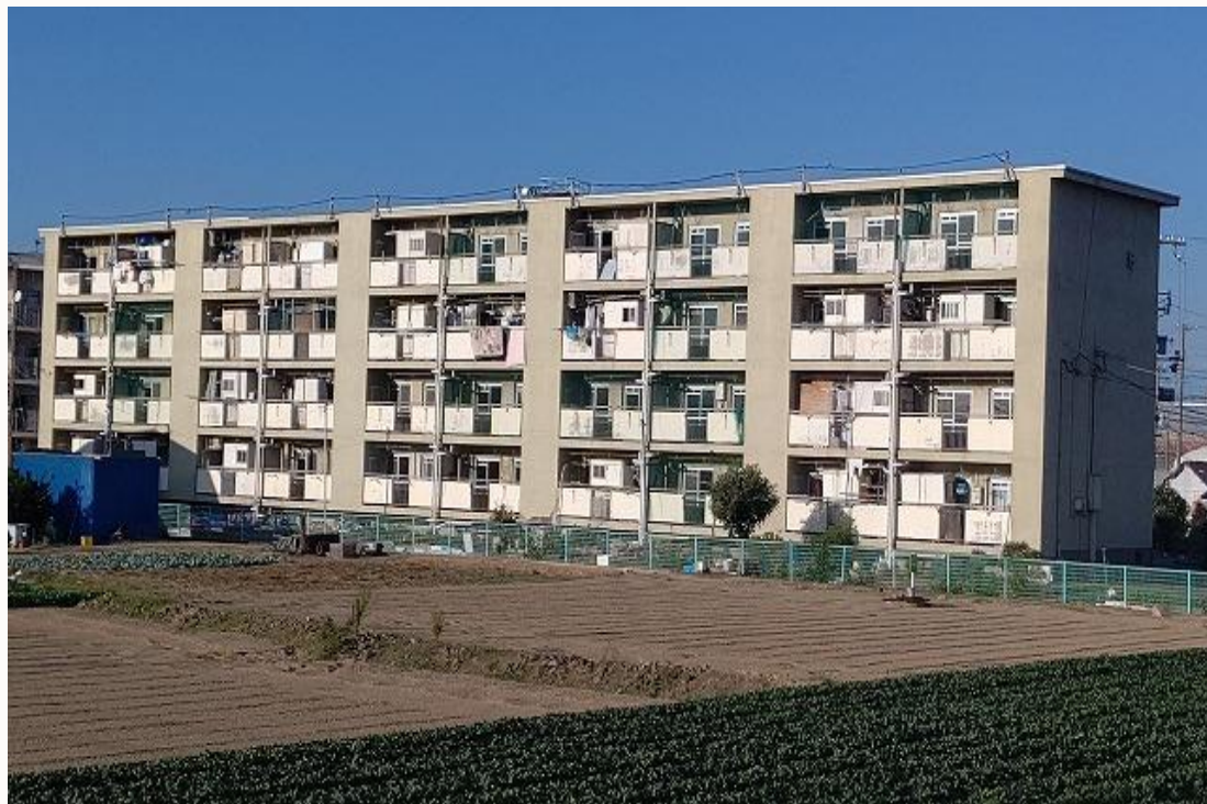
海側に面した6号棟は外壁劣化が進行していた
