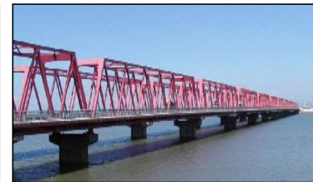
トラス橋の斜材の破断 (木曾川大橋)
