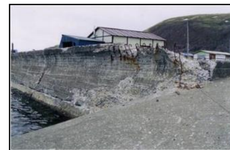
老朽化した海岸堤防
