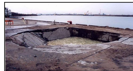
港湾施設エプロン部分の陥没
