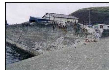
老朽化した海岸堤防
