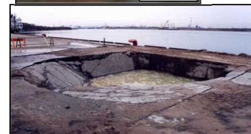
港湾施設エプロン部分の陥没
