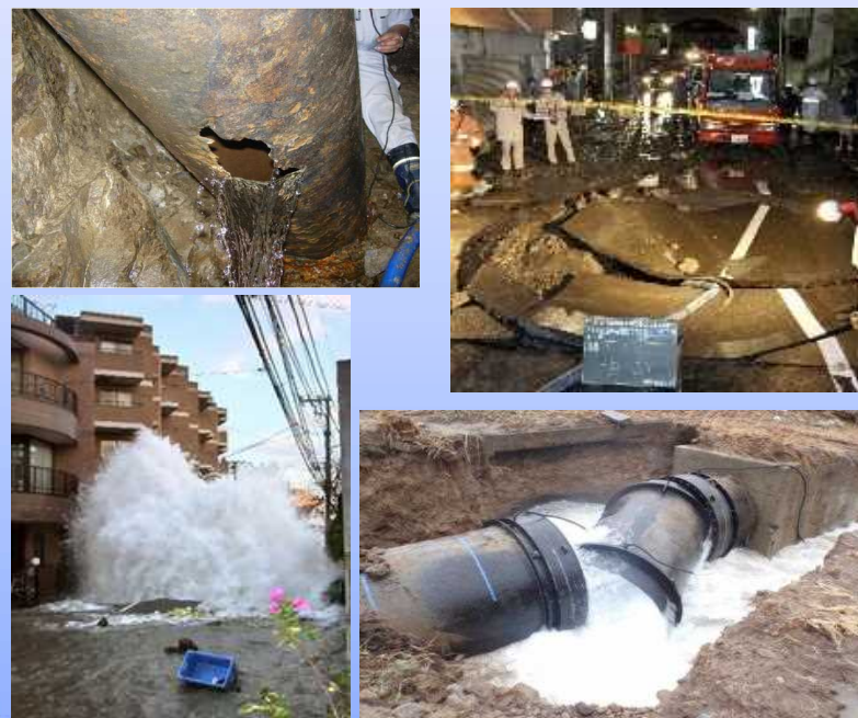
老朽化による事故の例
